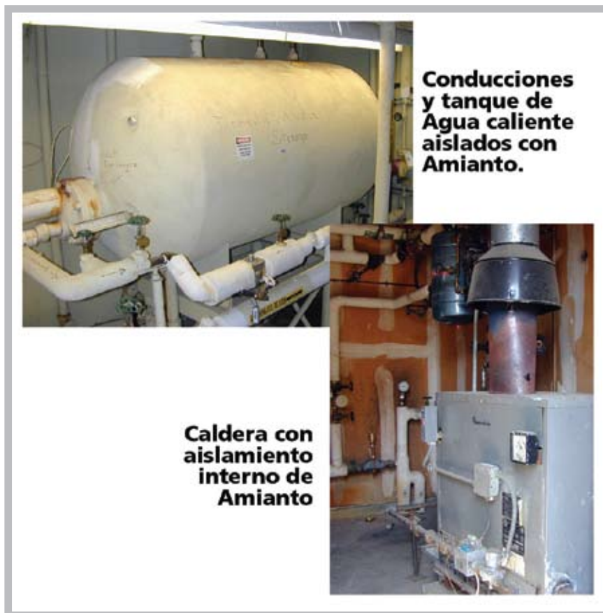
Amianto en cañerías.
