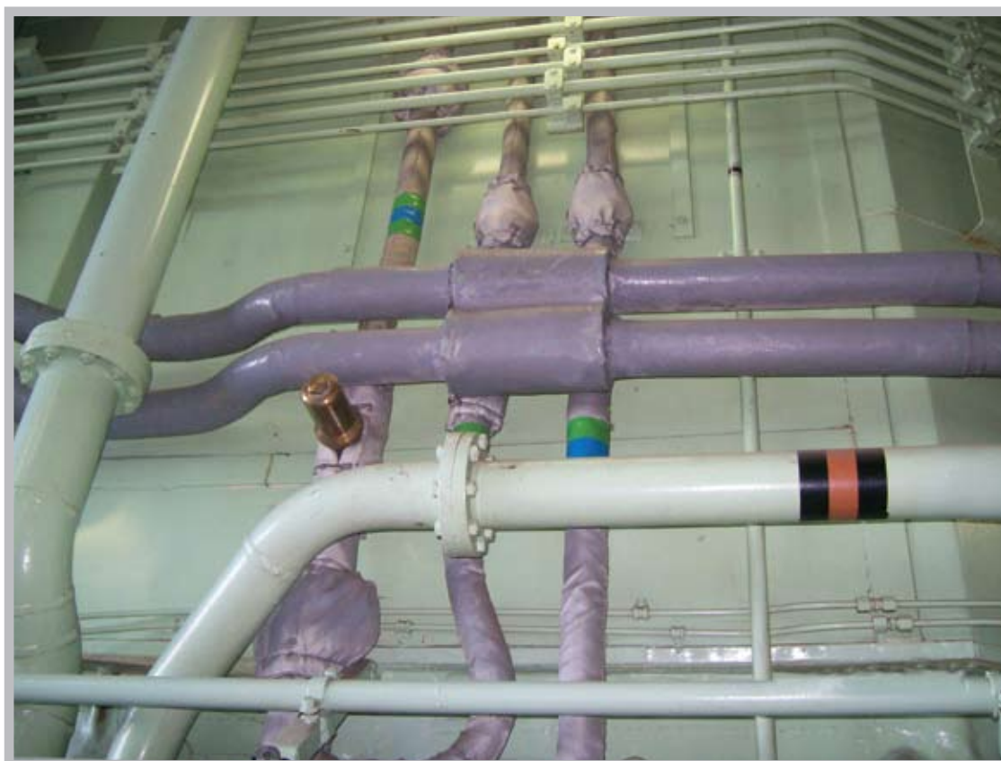
Conducciones de calderas protegidas por recubrimiento con amianto.
